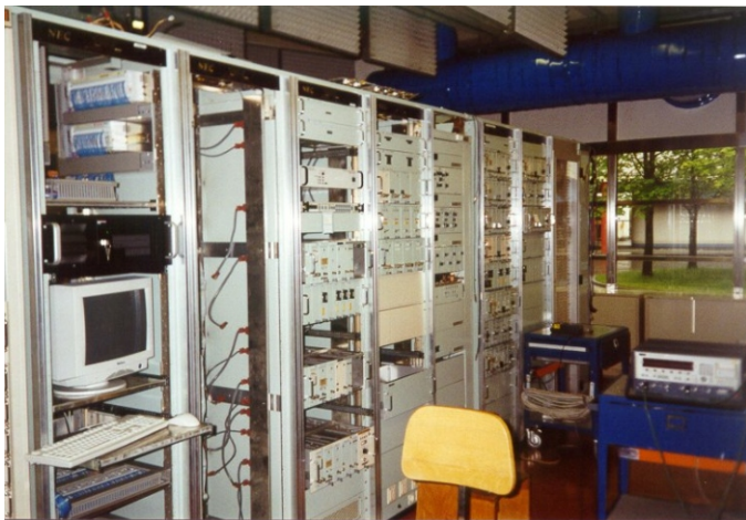
Aflenz - Hauptkontrollraum - Innenanlagen (Foto W. Löhnert)
